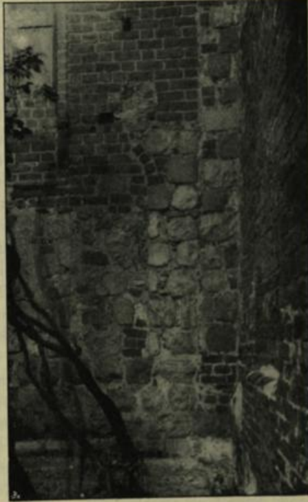
Abb. 349. Wusterhausen. Pfarrkirche. Fenster spur vom ehemaligen südlichen Seitenschiff der Basilika und Baunähte in der Ecke bei der Marienkapelle.
