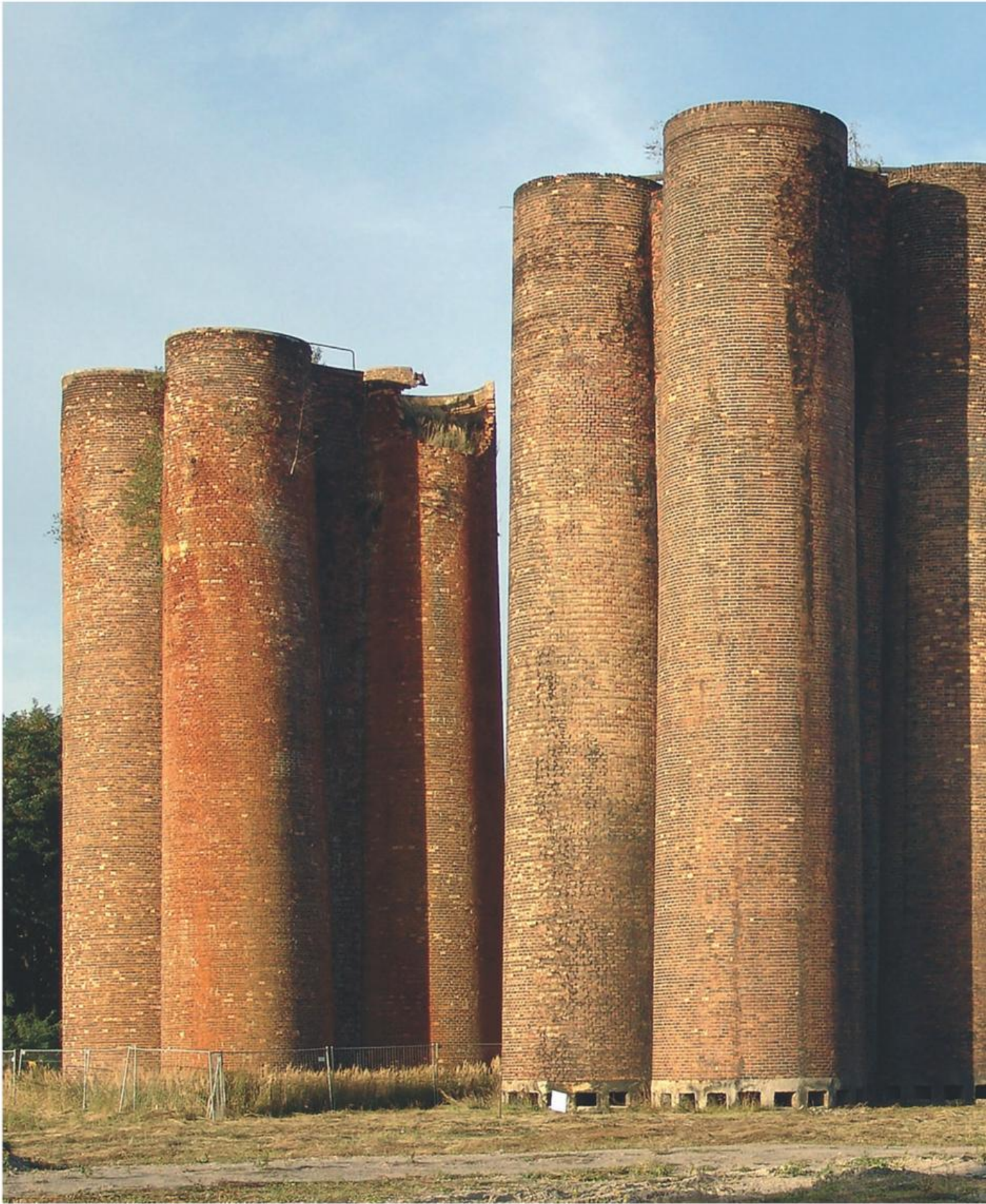
Lauchhammer (OSL), Turmtropfkörper (sogenannte Biotürme), 1956/57 in Betrieb genommene biologische Abwasseranlage zur Aufbereitung der Kokereiabwässer (Beseitigung der Restphenole) der ersten Braunkohlkokerei der Welt. Sie bestehen aus sechs Gruppen von mehr als 22 m hohen Turmtropfkörpern und dem sogenannten Belebtschlammbecken. Eine Turmtopfgruppe wird gegenwärtig zur Begehung für Besucher vorbereitet.
