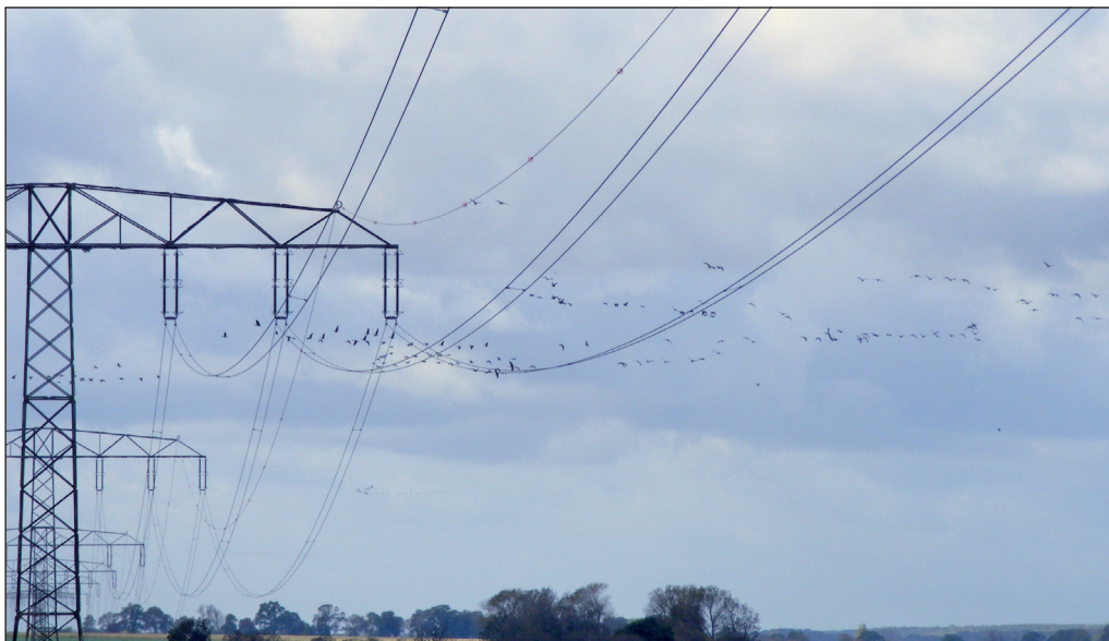
Abb. 1: Fliegende Kraniche über der mit roten Spiralen markierten 220-kV-Leitung im Oktober 2012 – hier erfolgte 2015 die beschriebene Massenkollision. Foto: F. Resch.
