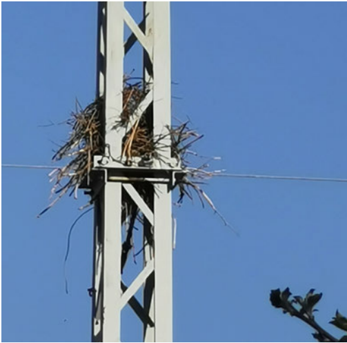
Abb. 8: Elsternest in einem Bahnüberleitungsmast. Foto: W. Bivour.
