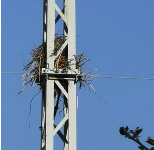
Abb. 8: Elsternest in einem Bahnüberleitungsmast. Foto: W. Bivour.
